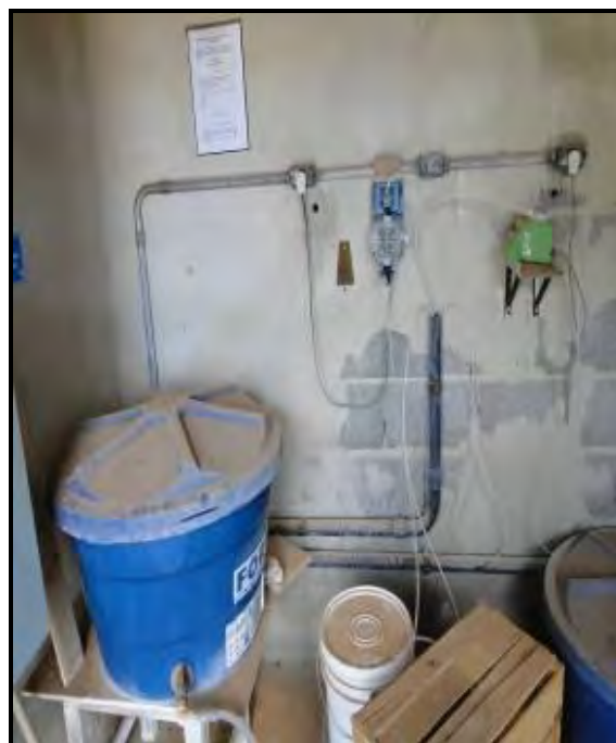
Figura 46 - Dosagem de cloro e flúor
