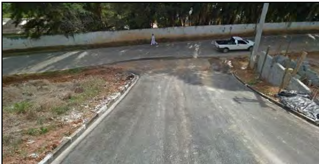
Figura 80 - Vista da Rua Paulo Ameri Trecho com alta declividade onde é constatada a inexistência de bocas de lobo e dissipadores de energia
