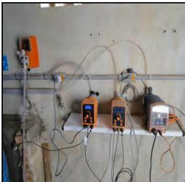
Figura 51 - Dosagem de cloro e flúor e correção de pH
