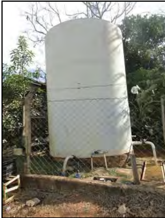
Figura 47 - Reservatório de 20m 3 - Bairro Aparecidinha
