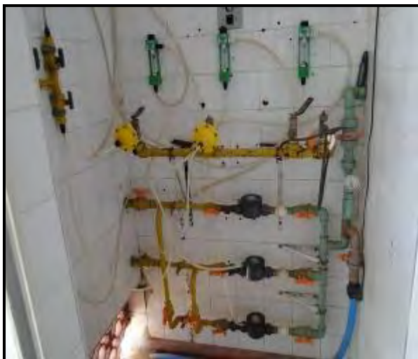
Figura 34 - Sala de dosagem de cloro.
