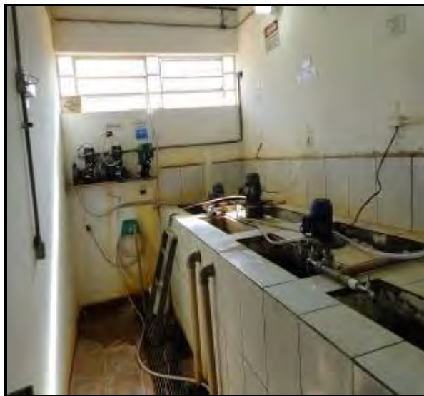
Figura 33 - Sala de preparação de soluções da ETA.
