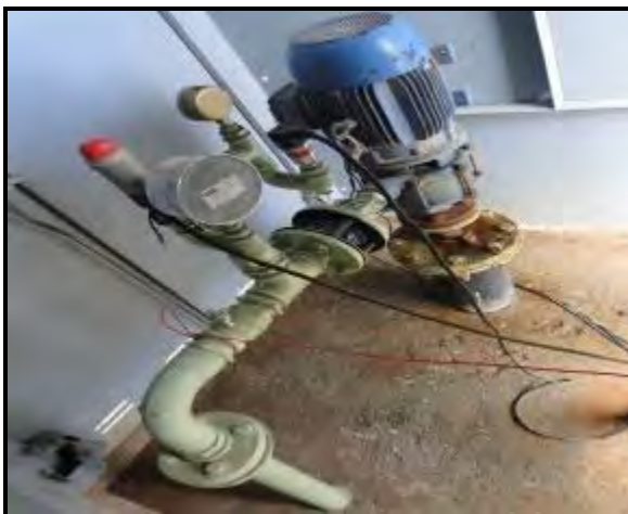
Figura 43 - Estação elevatória de água tratada - R2
