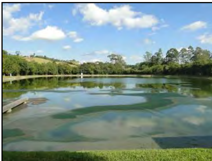
Figura 59 - Estação de tratamento de esgoto
