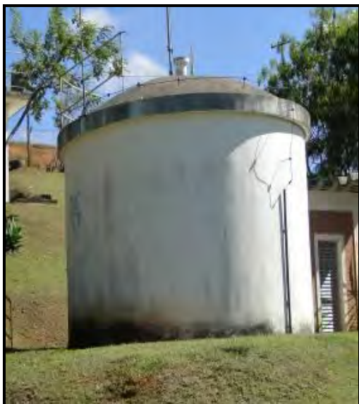
Figura 37 - Sistema de reservação – Reservatório ETA – 50 m 3
