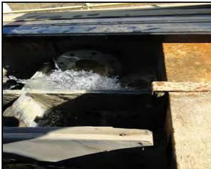
Figura 28 - Chegada da ETA
