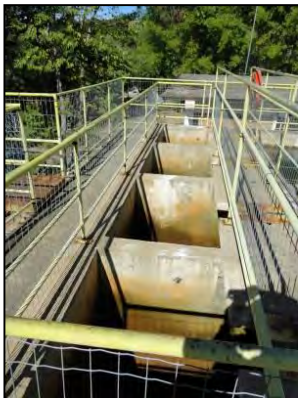
Figura 31 - Filtro da ETA
