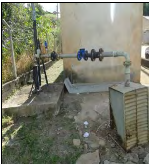
Figura 45 - Poço tubular profundo - Bairro Aparecidinha
