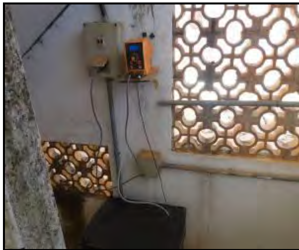
Figura 35 - Sistema de dosagem de flúor
