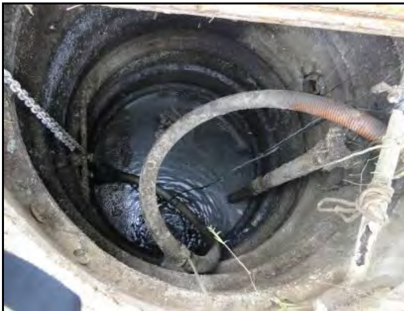
Figura 56 - Estação Elevatória de Esgoto Mutirão
