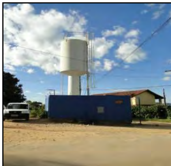
Figura 52 - Reservatório de 30 m 3 - Jardim do Pinhal
