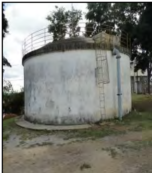
Figura 38 - Sistema de reservação – Reservatório R1 – 350 m 3
