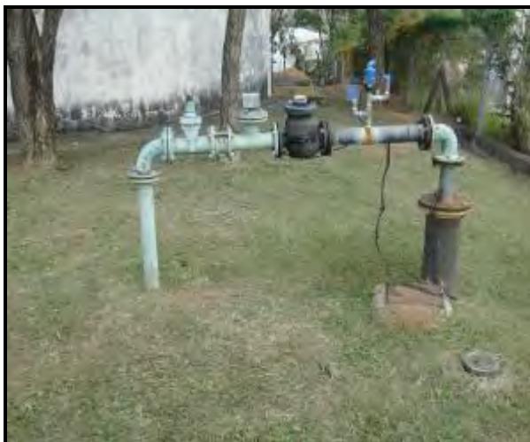
Figura 42 - Booster de água tratada para o Setor Limão e R1
