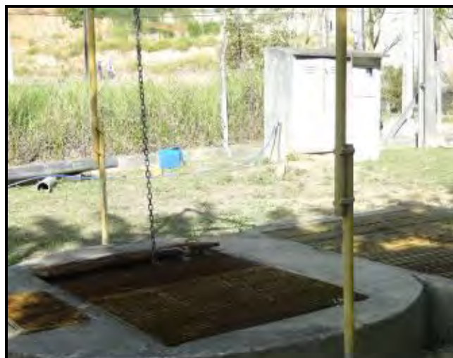
Figura 57 - Estação Elevatória de Esgoto Beneduzzi
